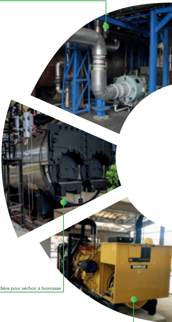
▽ Turbine à vapeur et chaudière à biomasse
