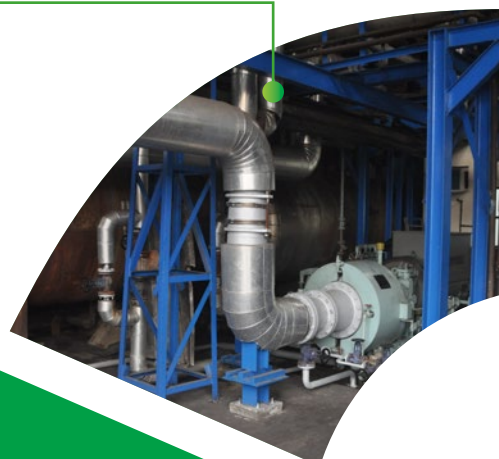
▽ Turbine à vapeur et chaudière à biomasse
